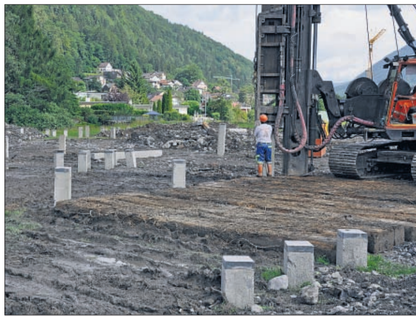
Über 500 Betonpfähle müssen mit dieser Maschine in den Boden gerammt werden. (Foto: ehu)
